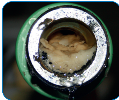
Foto 3: stark verkalkte 2 Zoll Wasserleitung
