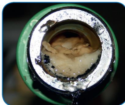
Foto 3: stark verkalkte 2 Zoll Wasserleitung
