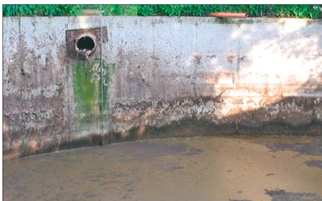
Güllegrube, nicht gerührt, zeigt gänzlichen Abbau der Schwimmschicht für aerobe Güllelagerung. Werkfoto
